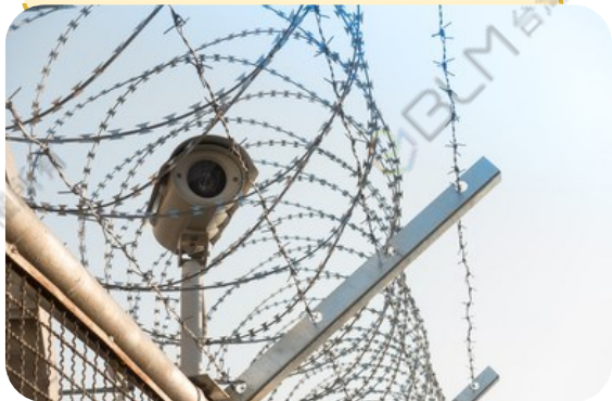
CCTV監控系統
