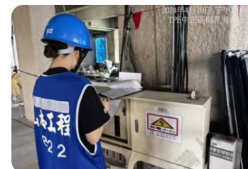
電氣設備定期巡檢
